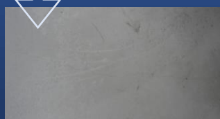
ハイグリップ・メタルバンド設置箇所 ひび割れ幅0.2mm未満
