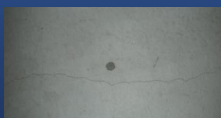
ハイグリップ・メタルバンド未設置箇所 ひび割れ幅0.3mm未満
